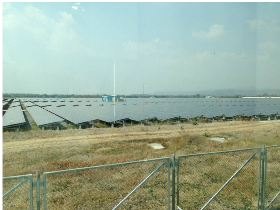
タイ・ロップリーの太陽光発電所(55MW)
